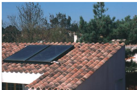
Capteurs solaires intégrés sur toiture neuve, Chéray
